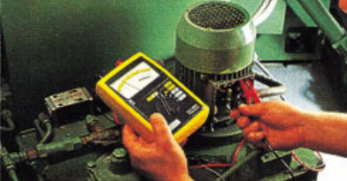
Contrôle de l'isolement des enroulements d'un moteur.
