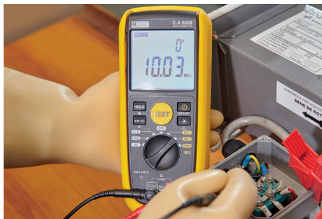
Maintenance préventive sur moteur
